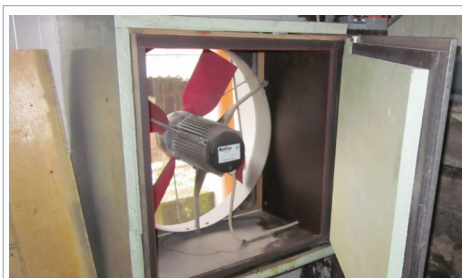
Im Wilhelmshof entwickelte luftdichte, automatische Klappe für Ventilatoröffnungen
