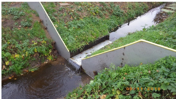
Abbildung 46: Einbau einer „Wand“ mit Absturz aus Blech ins Querprofil eines kleinen Fließgewässers. (Foto: W. Rötter)
