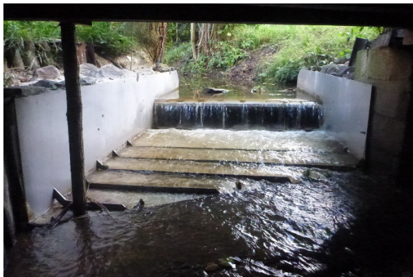
Abbildung 35: Untere Sperre einer generischen Doppelsperre (korrespondierend mit der Sperre in Abbildung 36). Verblechung und Überkragung eines neu gebauten Absturzes mit zusätzlicher Verblechung des gesamten Querschnitts. Zwischen den beiden Sperren befindet sich ein Monitoringbereich. Die Sperre dient dem Schutz des größten bekannten Bestands von A. astacus in Nordrhein-Westfalen. (Foto: H. Groß)
