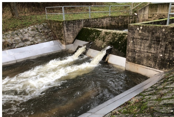
Abbildung 44: Auslaufbauwerk nach Einbau der Verblechung. Rundum wurden Edelstahlbleche angebracht, um NICS am Verlassen des Tosbeckens zu hindern. Die beiden Auslaufscharten wurden ausgeblecht und mit einer Überkragung versehen, damit ein Absturz entsteht und der Wasserstrahl abgelöst wird. Auftretendes Bio-Fouling wird regelmäßig mit einem Hochdruckreiniger entfernt (Hennings, 2019, schriftliche Mitteilung). Träger der Maßnahme war der Gewässerverband Bergstraße, eine Finanzierung erfolgte aus Landesmitteln des Naturschutzes (Heinz, 2019b, schriftliche Mitteilung). (Foto: R. Hennings)
