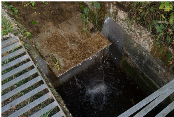
Abbildung 37: Der vorhandene Absturz in den Schacht wurde durch Verblechung modifiziert. Der Schacht ist mit einem Gitter abgedeckt. (Foto: Verfasser).
