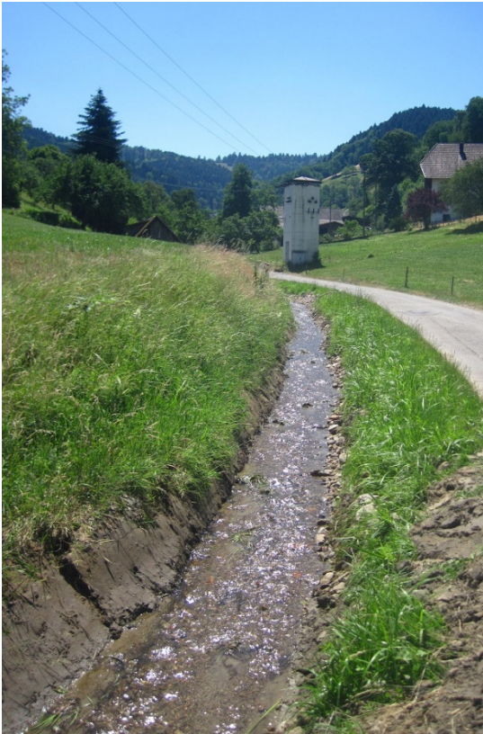
Abbildung 23: Zustand nach Grabenräumung eines kleinen Mittelgebirgsbaches in Baden-Württemberg, der die Funktion eines Wegseitengrabens erfüllt. Vermutlich erfolgte die Maßnahme, um den Abflussquerschnitt freizuhalten. Kurz zuvor wurde durch Kartierung ein individuenreicher Bestand von A. torrentium im Gewässer belegt. Es ist von einer erheblichen Beeinträchtigung der Population auszugehen, da bei der Räumung auch in die Sohle des Gewässers eingegriffen wurde (Pfeiffer, 2019, mündliche Mitteilung). (Foto: M. Pfeiffer)
