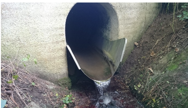
Abbildung 42: Teilverblechung eines Durchlasses zur Erzeugung eines Absturzes und als Schutz vor seitlichem Einklettern. (Foto: C. Günter)
