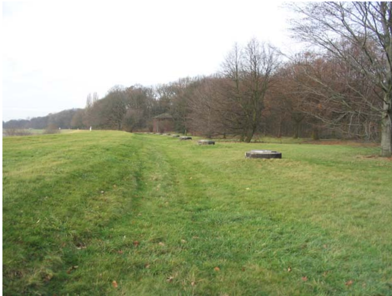
Abb. 7: Entnahmepumpen der Uferfiltrationsanlage, 50 m vom Rhein entfernt
