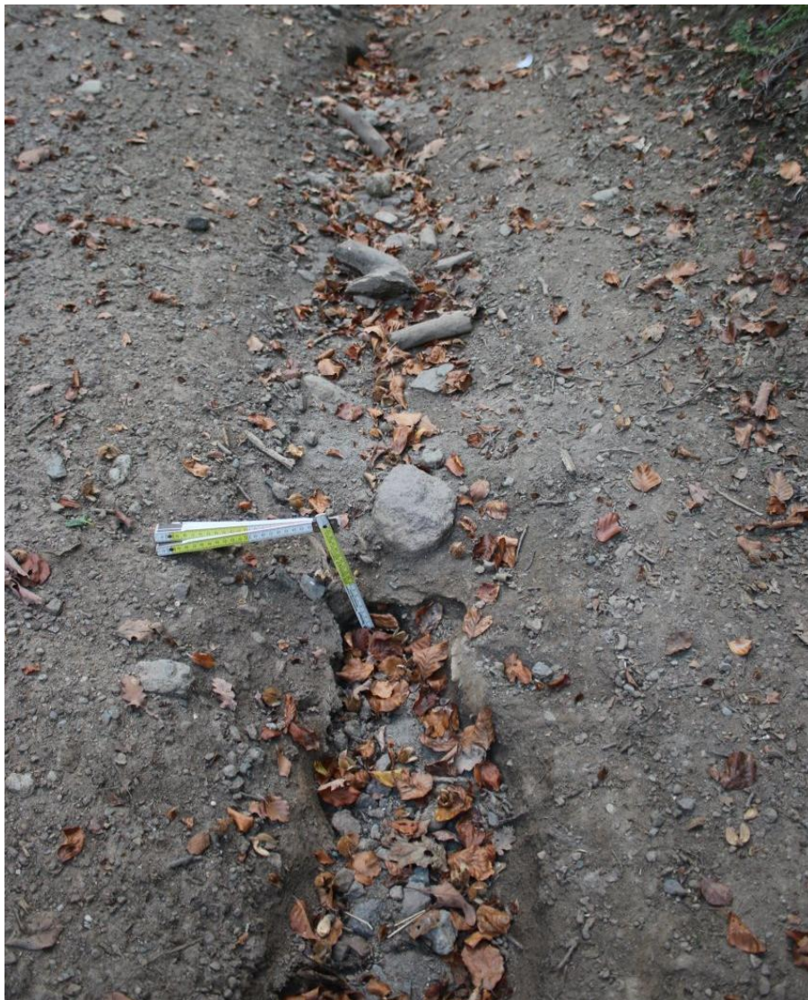
Abb. 8.1: Deutliche Eintiefung der linearen Erosionsformen im Fahrspurbereich eines Weges der Kategorie 2, September 2014.
