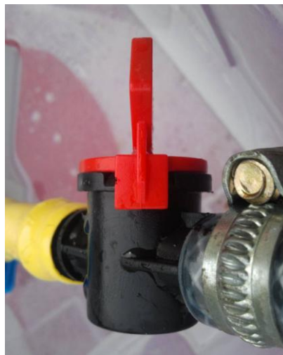
Abb 5.12: Sperrventil des Wasserkreislaufs an der KBA.
